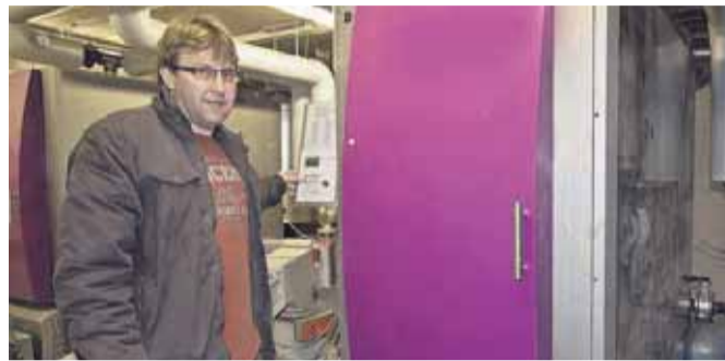
Geschäftsführer Gerd Pieper vor der Hackschnitzelanlage für das Nahwärmenetz.
